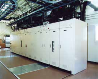
④ S帯電力増幅装置 20kw出力の水冷式クライストロンです。
