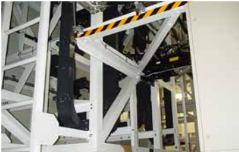
⑧ S/X共用ホーン ビーム伝送部からの電波をS帯、X帯に分離、低雑音増幅器に導くとともに、S帯、X帯の送信電波をビーム伝送部に向けて送り出します。低雑音増幅器に導き増幅します。
